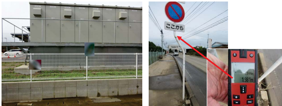
左：高所設置により水没を免れた屋外キュービクル、右：付近の浸水痕と浸水深の測定値
