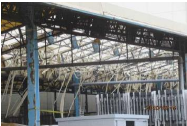
外航バース側テント倉庫天井部のシートの裂け・破れ
