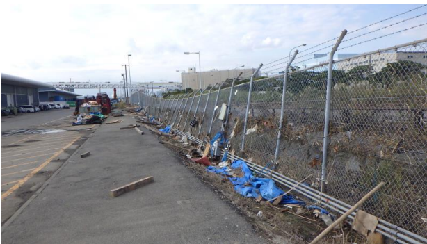
高潮と浮遊物漂着で変形したバース先端部フェンス
